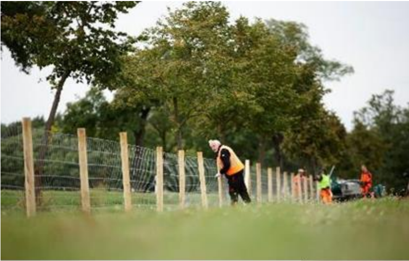
図5 ドイツ・ブランデンブルグ州における建設中のフェンス
